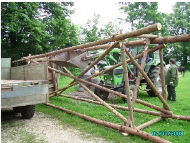
Bau der 8 m hohen Saukanzel „Doppeldecker“ Oben die Kanzel, unten der integrierte Ansitz
